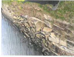
E Collapsed revetment
